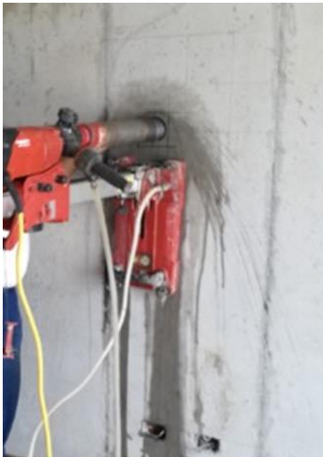
Figura 1. Extracción de núcleos para determinar la resistencia del concreto. Fuente: Mixto Listo.
