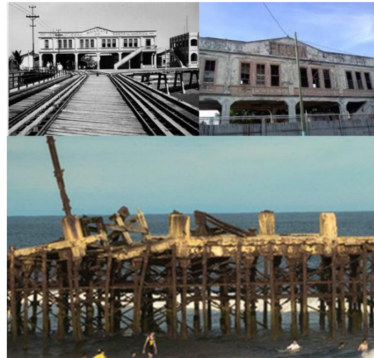
Figura 3. Ejemplo de Concreto deteriorado debido al ataque de sulfatos. Edificio de la terminal y muelle del Puerto de San José Escuintla. Fuente: Wikipedia enciclopedia libre.
