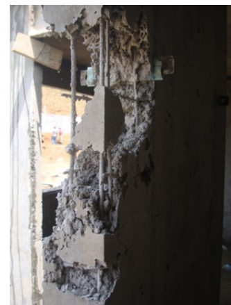
Figura 2. Ejemplo de mala consolidación de un concreto convencional colocado en un muro delgado. Un CAC evita la formación de oquedades o ratoneras. Fuente: Mixto Listo.
