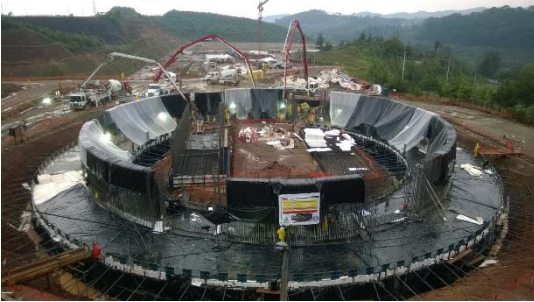
Figura 8. Ejemplo de fundición masiva en la cimentación de un silo. Fuente: ICCG.
